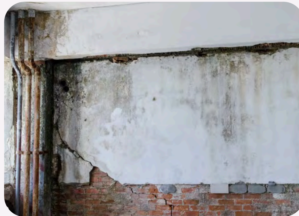
großer Schimmel befall
